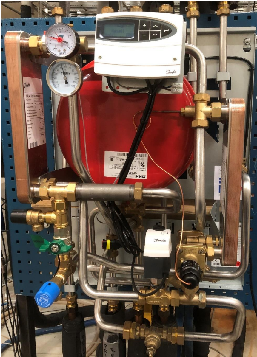
Figur 1. Fjärrvärmecentralen vid provning.
